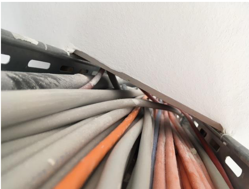
Abbildung 3: nicht abgeschotteter Wanddurchbruch BT1
